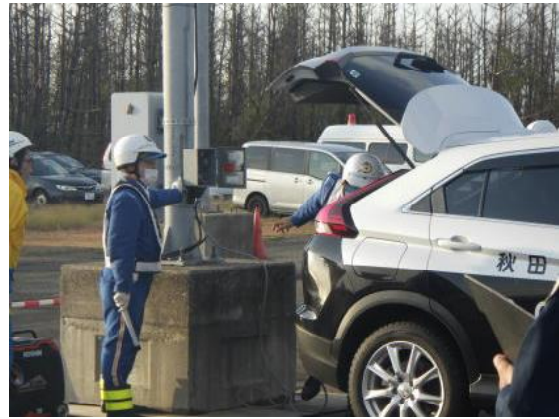
ハイブリッド車から仮設信号機への電源供給
